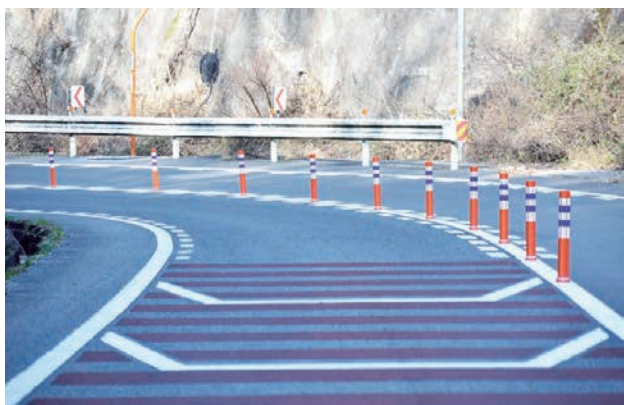
中央分離帯視線誘導
